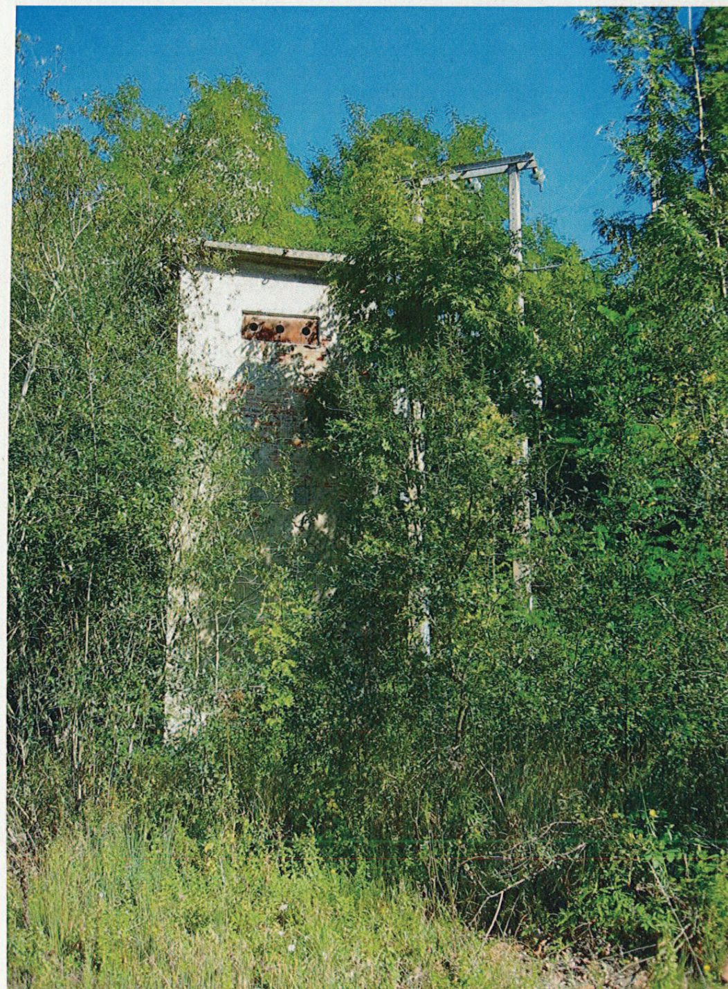
Antiguo transformador de la Tejera.
