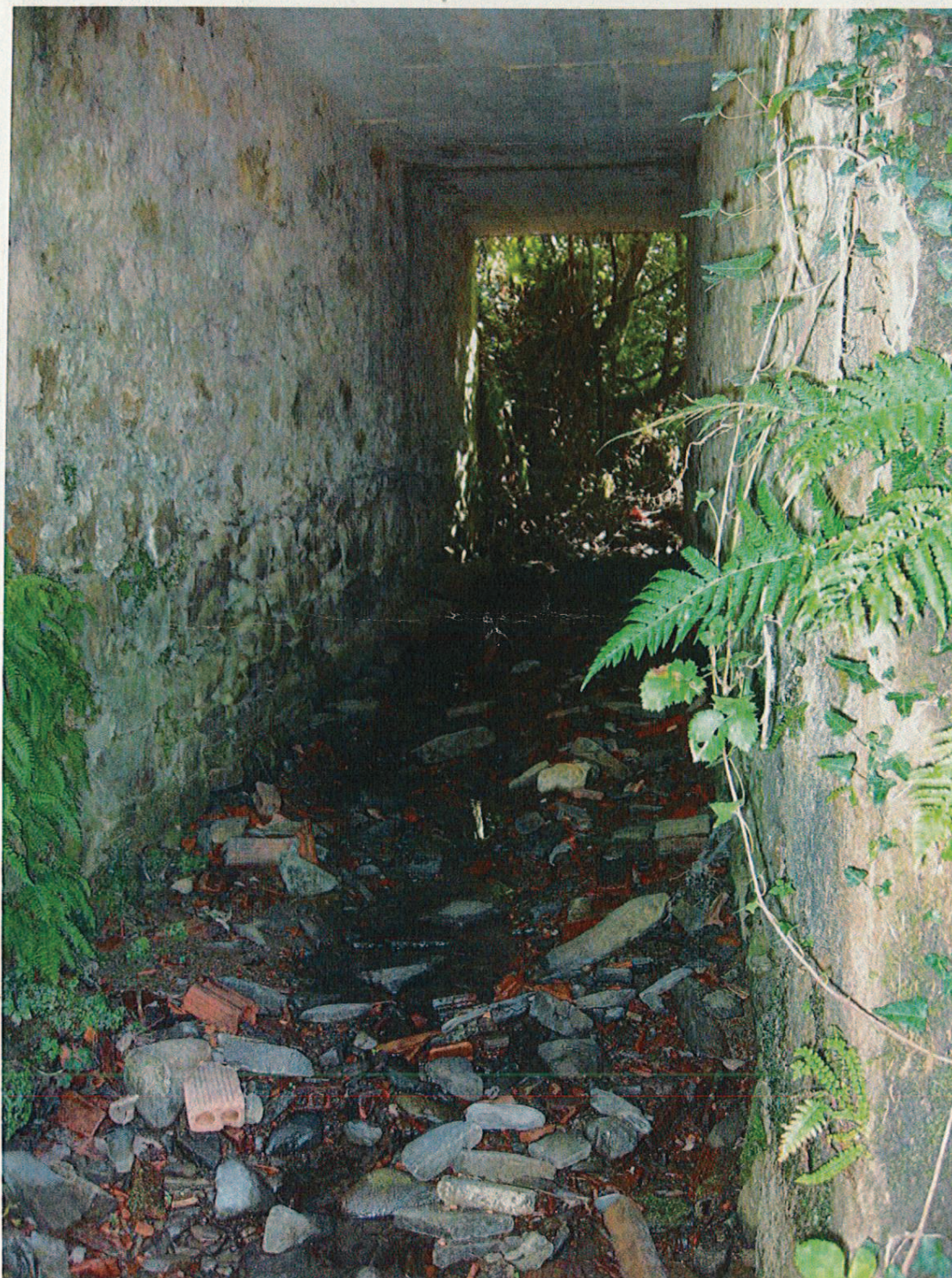
Restos de escombros a lo largo del cauce.
